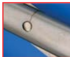
Pukotina na zglobu
