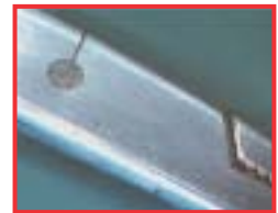
Pukotina na zglobu
